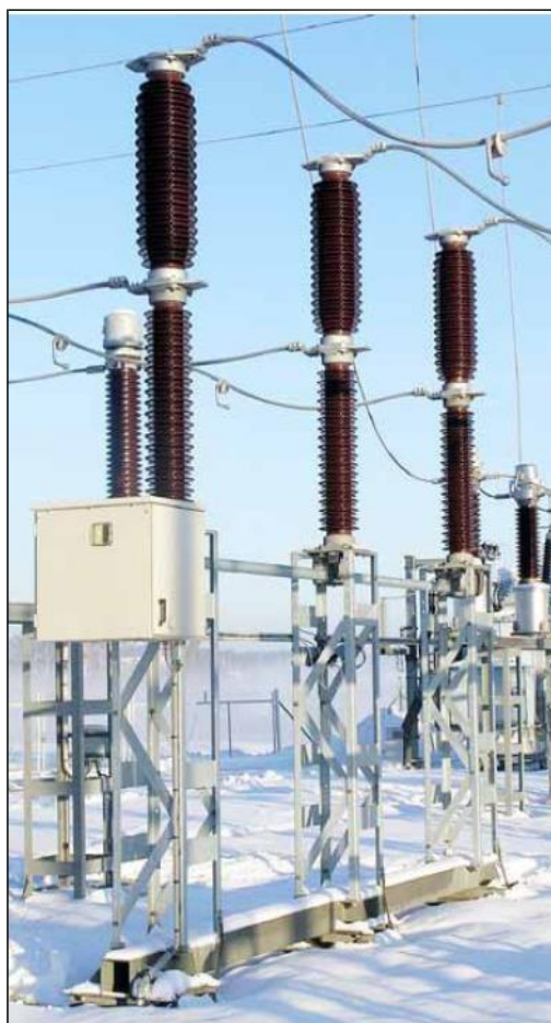
Figura 9.13. Particolare Interruttore con TA incorporato.
