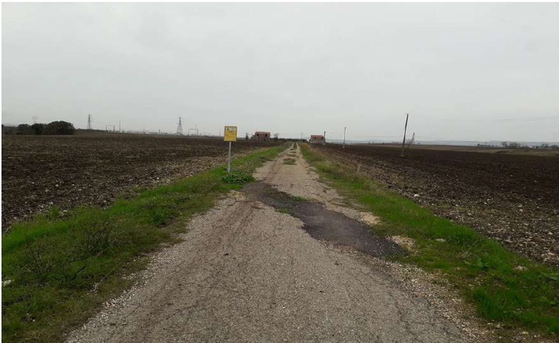
70 - Rotello (CB) c.da Verticchio, UR 4 panoramica del segmento di cavidotto di collegamento corrente su strada Verticchio in direzione N, verso il campo 7
