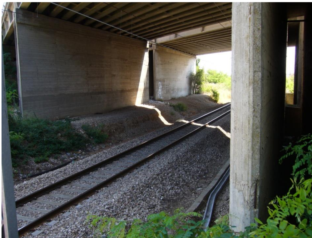
Foto 1 CVF autostrada A14
