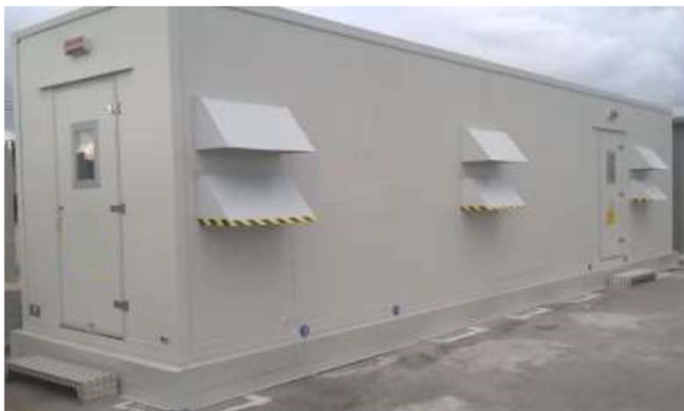
Figura 7: Tipologico shelter per alloggiamento batterie
