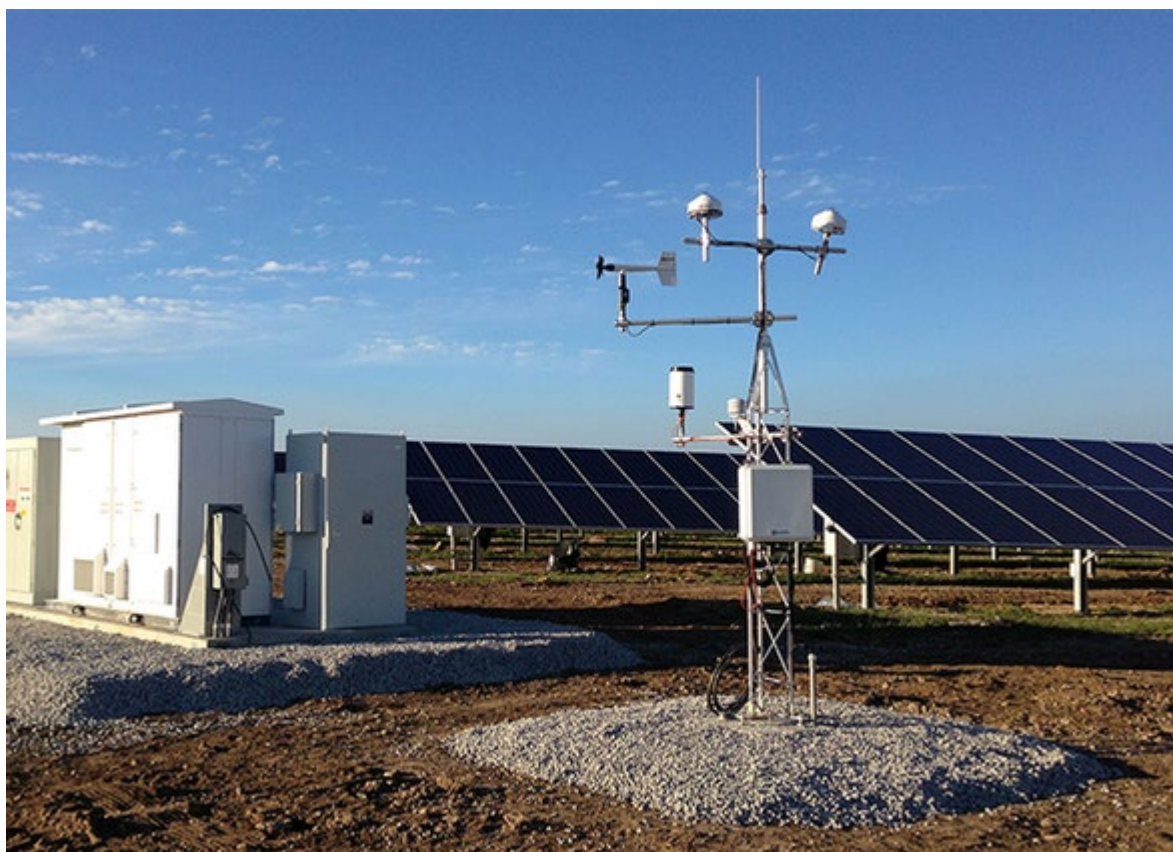
Stazione meteo dedicate all'impianto fotovoltaico
