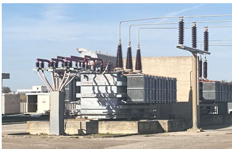
Tipico trasformatore di potenza AT/MT ONAN
