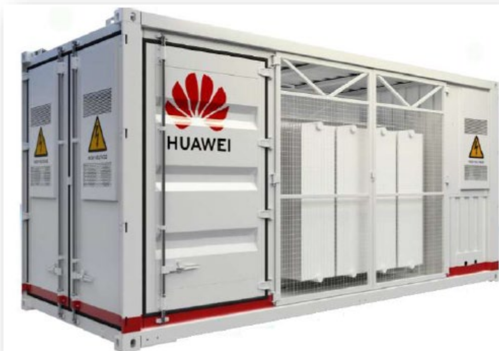
Figura 13 - Esempio stazione di trasformazione di campo
