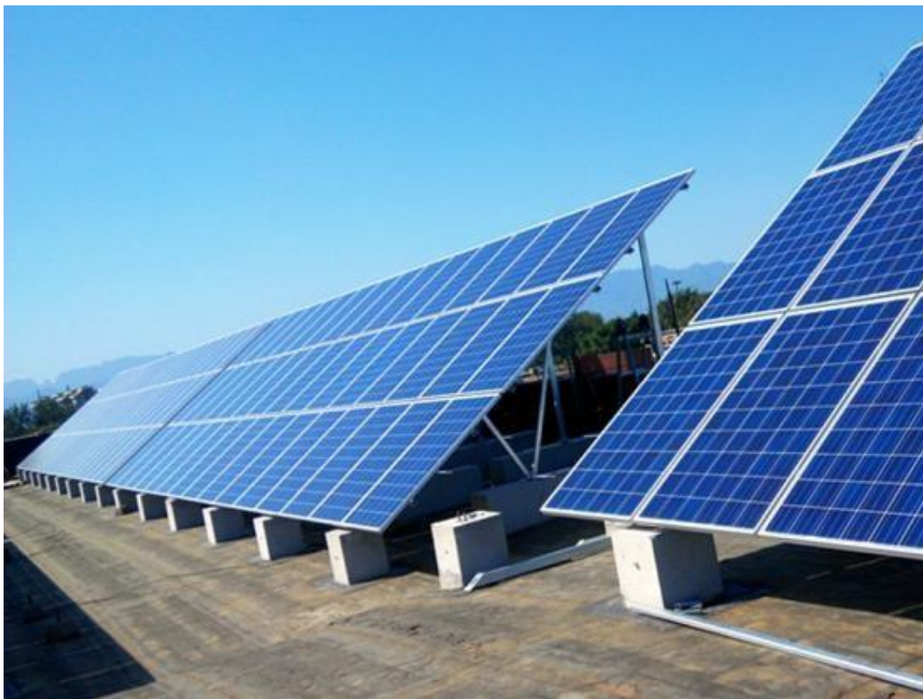
Figura 2.1. 5 – Esempio di impianto fotovoltaico con fondazioni formate da zavorre costituite da plinti in cemento.
