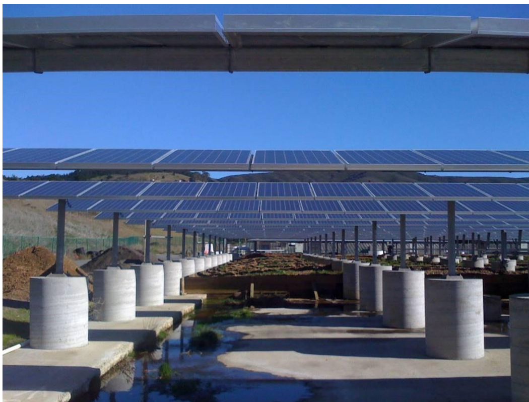
Figura 3.3.1.4 – Esempio di impianto fotovoltaico con fondazioni formate da zavorre costituite da plinti in cemento.
