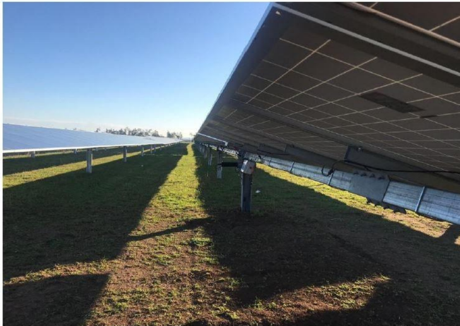
Figura 3.3.1.1 – Esempio di impianto fotovoltaico realizzato con supporti costituiti da pali in acciaio infissi direttamente nel terreno.
