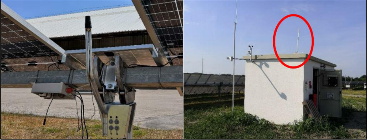
Figura 3.11: Esempio di collegamento - L'antenna TP sul tracker (a sinistra) e l'antenna del RP nella parte superiore della stazione di trasformazione (a destra).
