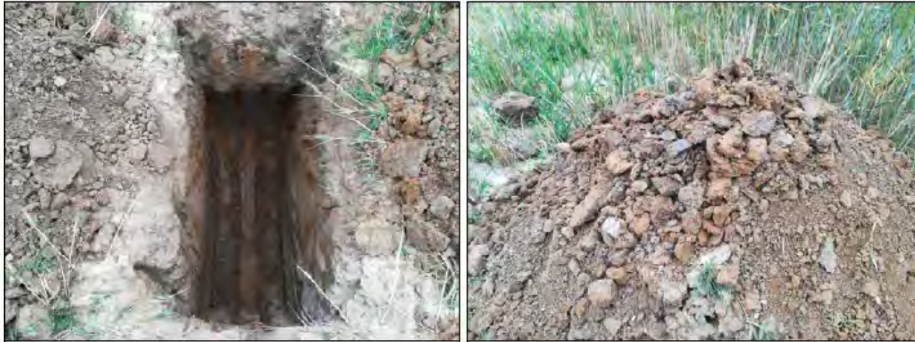
Figura 5.14: fase di realizzazione del pozzetto geognostico P1 (a sinistra) e materiale estratto (a destra).
