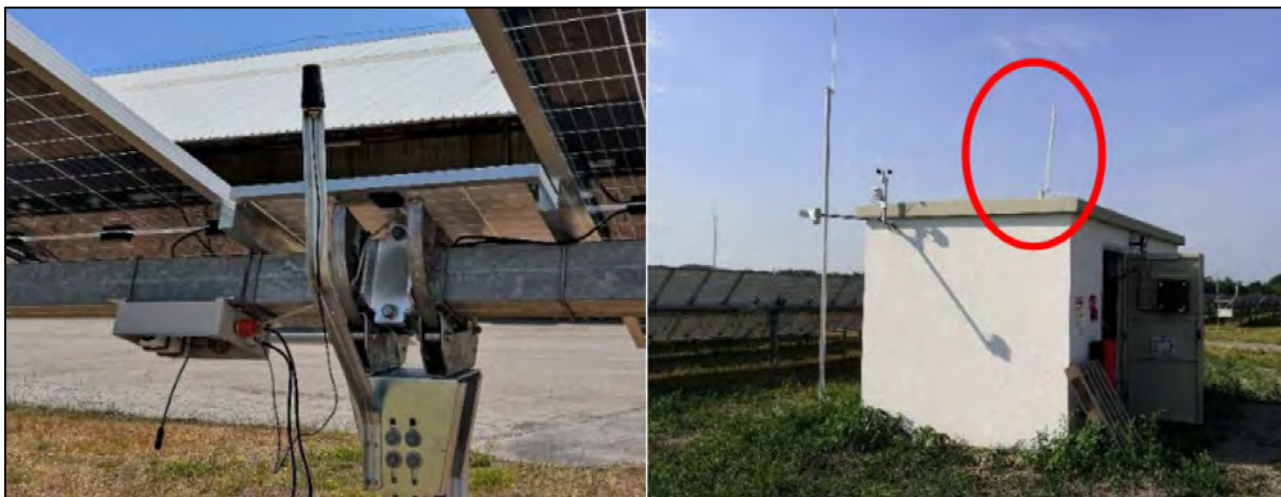
Figura 4.11: Esempio di collegamento - L'antenna TP sul tracker (a sinistra) e l'antenna del RP nella parte superiore della stazione di trasformazione (a destra).
