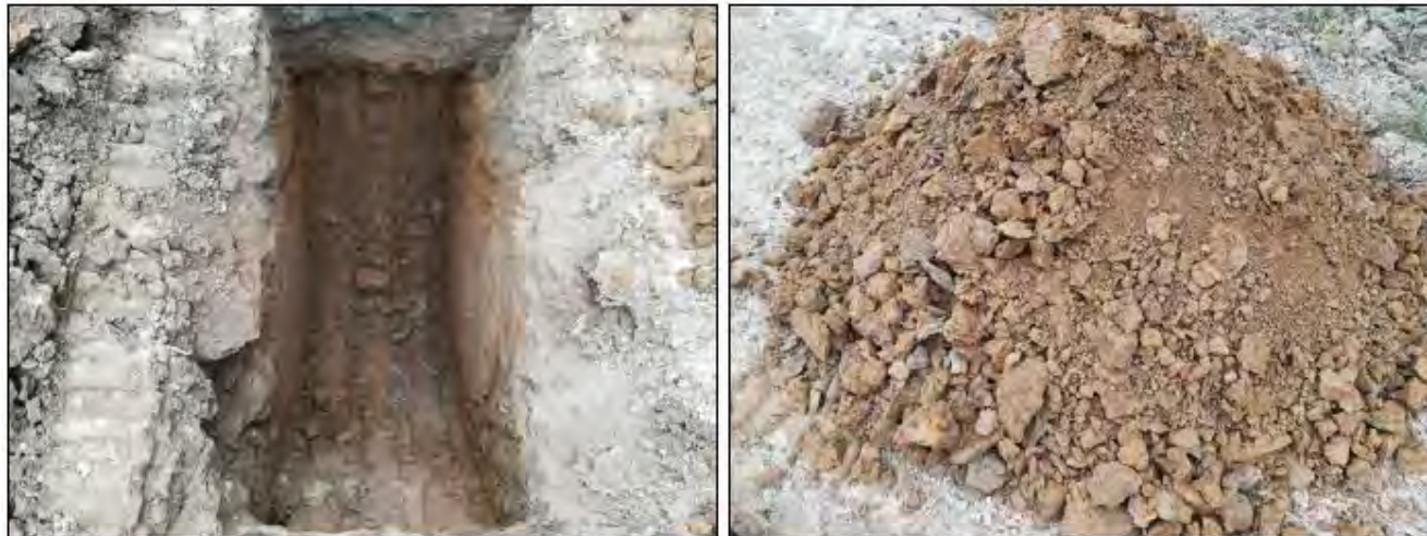
Figura 5.15: fase di realizzazione del pozzetto geognostico P2 (a sinistra) e materiale estratto (a destra).
