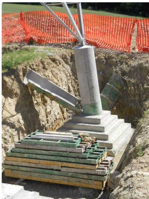
Realizzazione di fondazioni superficiali tipo CR per un sostegno a traliccio. Nell'immagine si può osservare una fondazione CR appena "scasserata". Si possono distinguere facilmente la parte inferiore a parallelepipedi tronco piramidali ed il colonnino di raccordo con la "base" del sostegno (immagine d'archivio)
