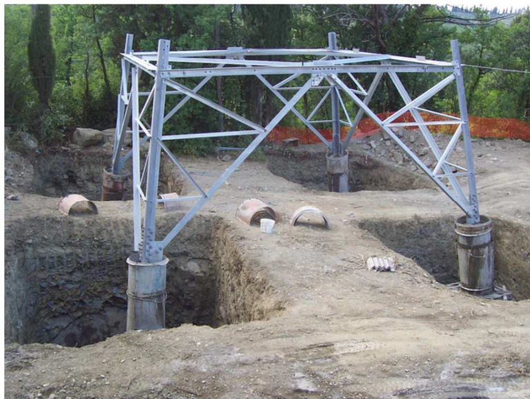
Realizzazione di fondazioni superficiali tipo CR per un sostegno a traliccio. Nell'immagine si possono osservare le quattro buche, la base del sostegno collegata alla fondazione tramite i "monconi" ed i casseri utilizzati per i quattro "colonnini" (immagine d'archivio)
