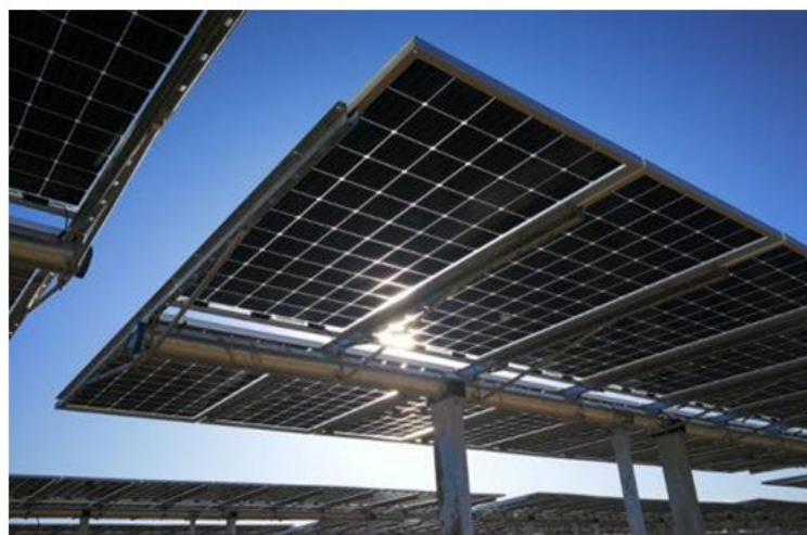
Figura 2.18: Particolare strutture di sostegno moduli
