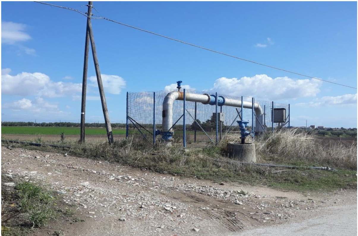
Particolare dell'impianto irriguo consortile
