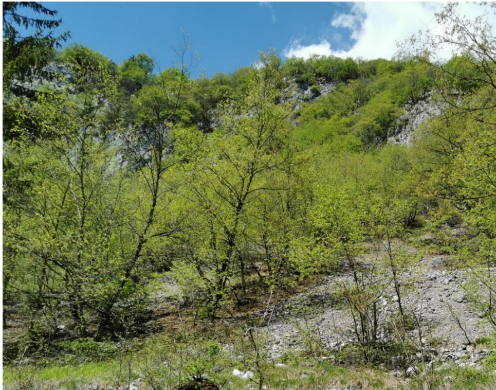
Figura 50: Detrito di falda presente sul versante sopra la viabilità al di sotto della quale sarà posato l'elettrodotto in cavo interrato, nel settore a pericolosità H3 e H4
