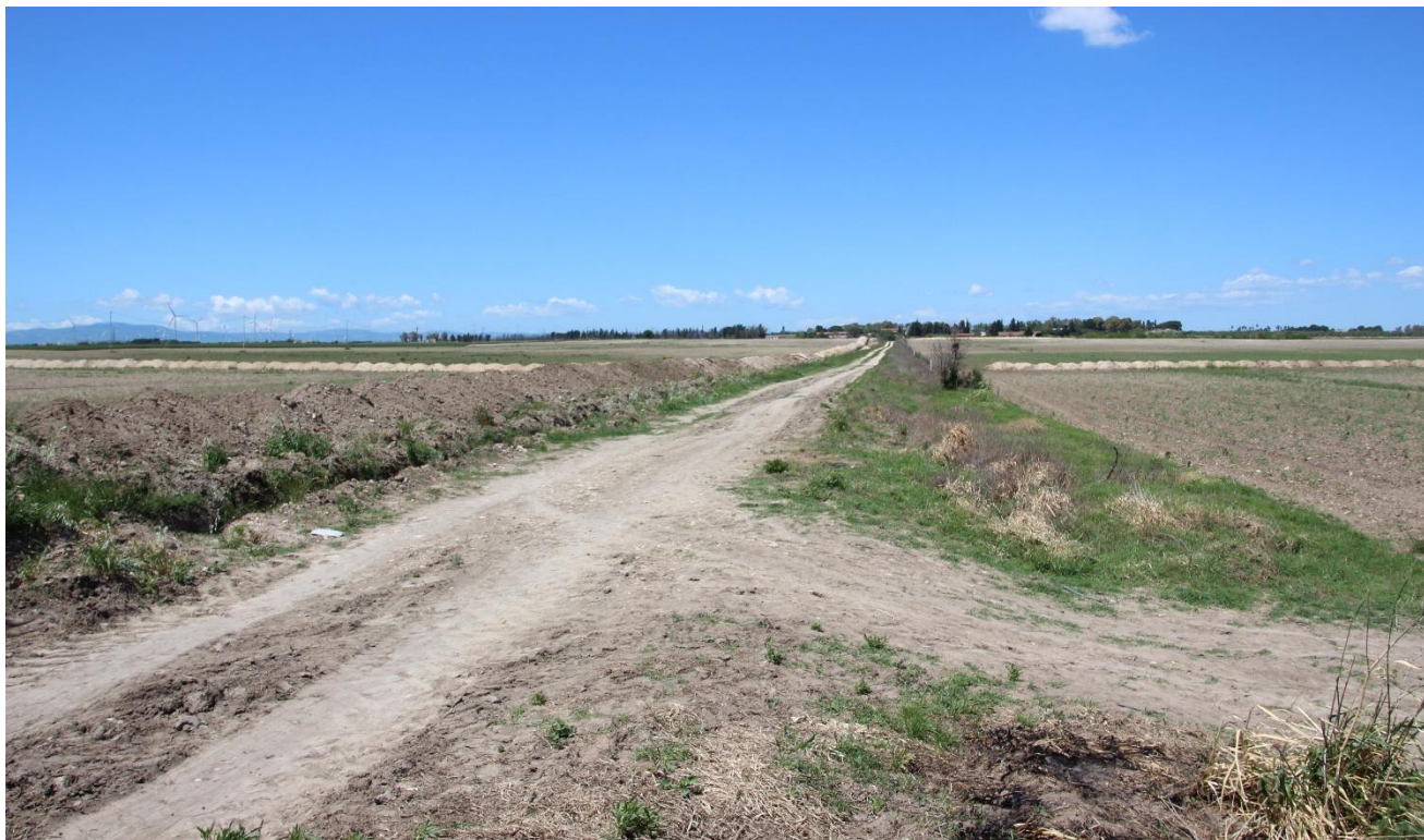
Accesso WTG 7 Viabilità esistente con pavimentazione naturale in pessimo stato
