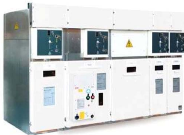
Assemblamento di diversi scomparti per la realizzazione del Quadro completo
