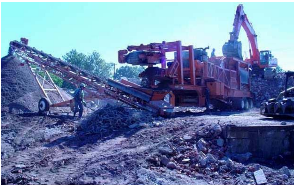
Figura 14: impianto mobile di valorizzazione
