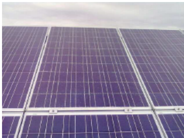
Tavola n. 21: Modulo con superficie compromessa
