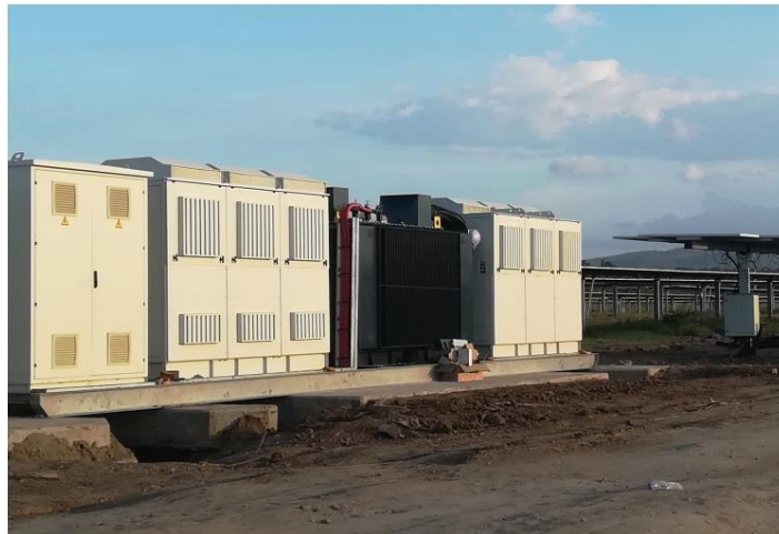
Esempio skid conversione
