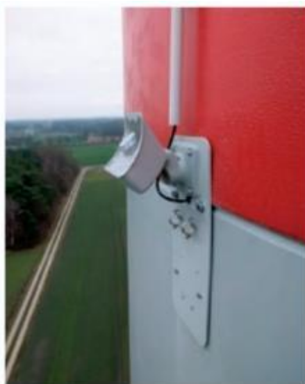
Figura 81 - Sistema radar chiroterri
