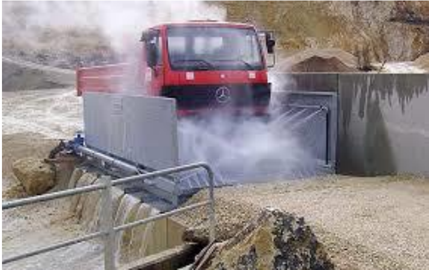
Figura 87 - Sistema abbattimento polveri mediante bagnatura ruote mezzi di lavoro
