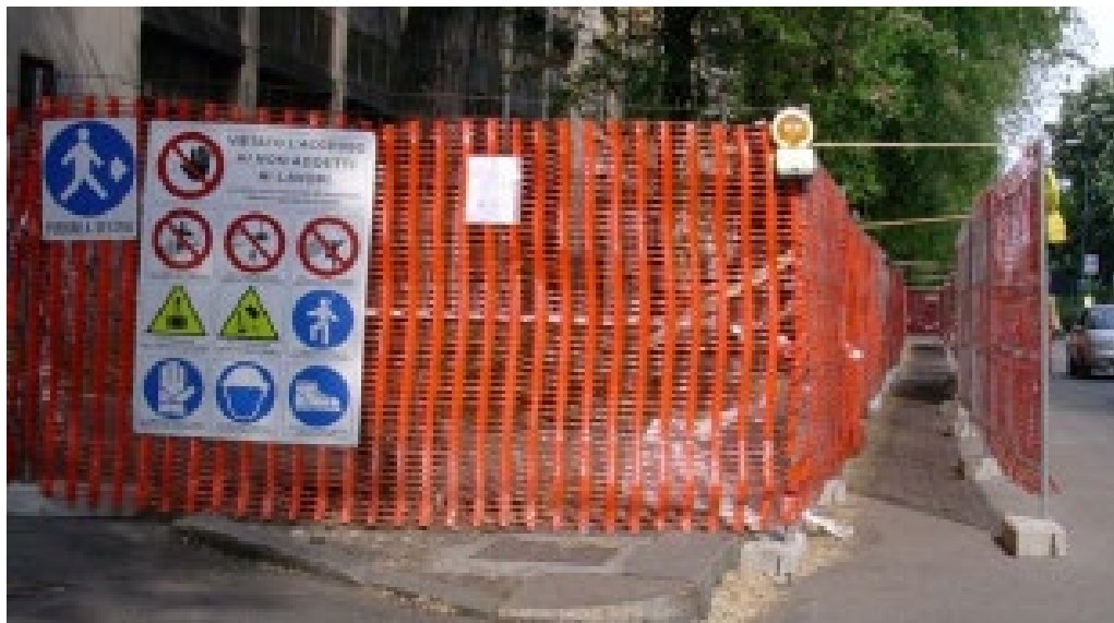
Foto 3-1: Esempio di recinzione in rete zincata con integrazione di rete in PVC a maglia ovoidale
