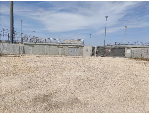
Foto 34. P.Ila 58. Stazione Elettrica Terna
