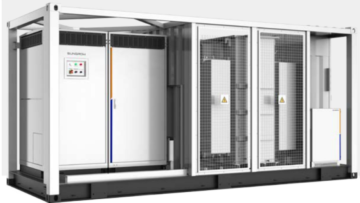
Figura 20: Sistema di potenza di conversione energia batterie
