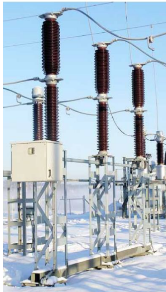
Figura 9: Interruttore AT 170 kV
