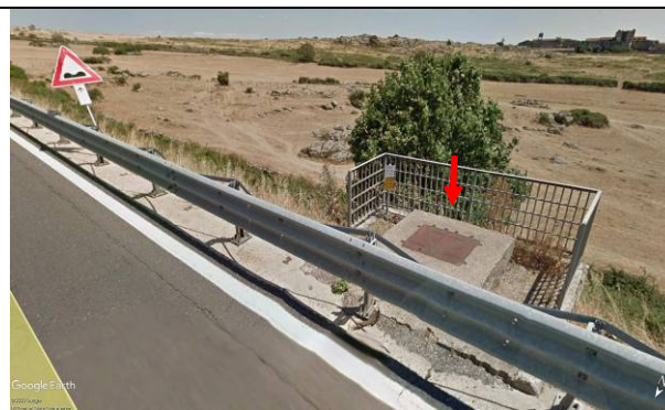
Foto 44c - S13 CS: pozzetto rete fibre ottiche sez. 36 con relativo manufatto di protezione.
