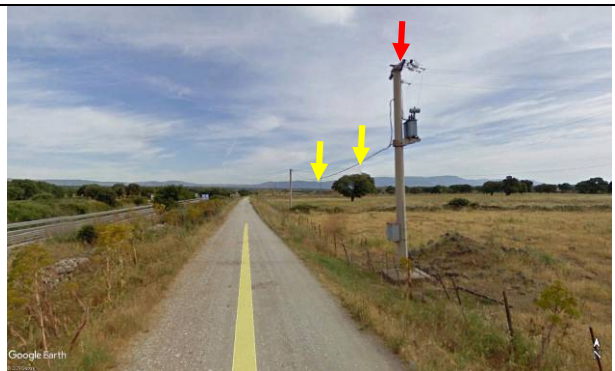
Foto 54d - Locale B: Cabina di trasformazione di Mt su palo (freccia gialla) e linea di BT parallela al tracciato
