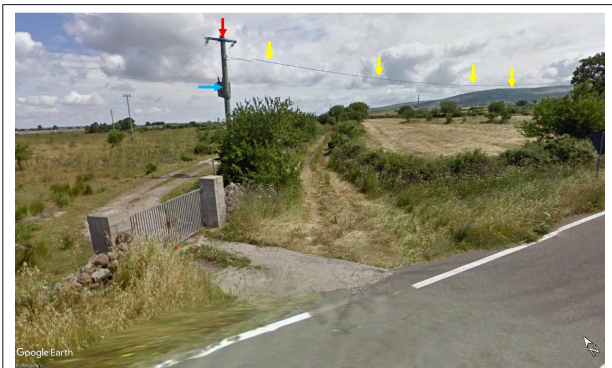
Foto 19d - Traliccio della linea Enel di Mt (freccia in rosso) con trasformatore su palo (freccia ciano) e linea elettrica di Bt in derivazione (freccie gialle)
