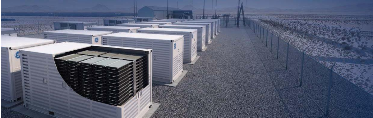
Batterie agli ioni di litio in una centrale di accumulo
