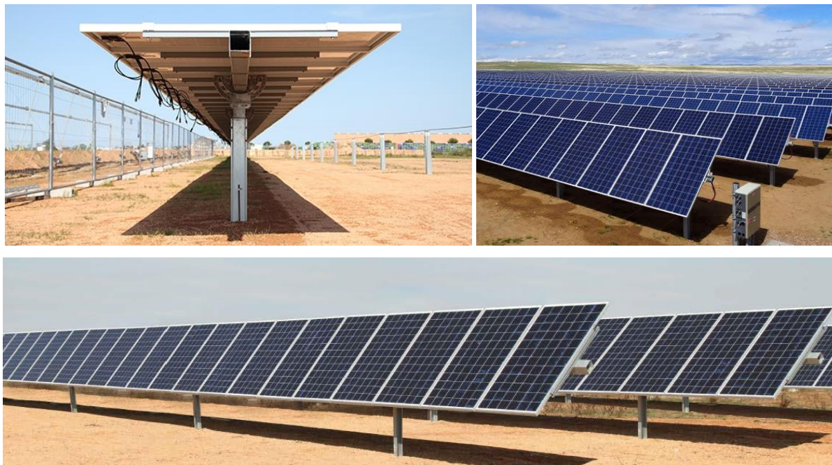
Particolare inseguitore monoassiale est-ovest
