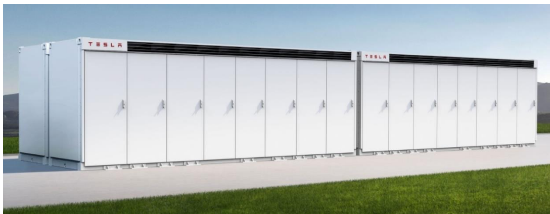
Batterie agli ioni di litio in una centrale di accumulo
