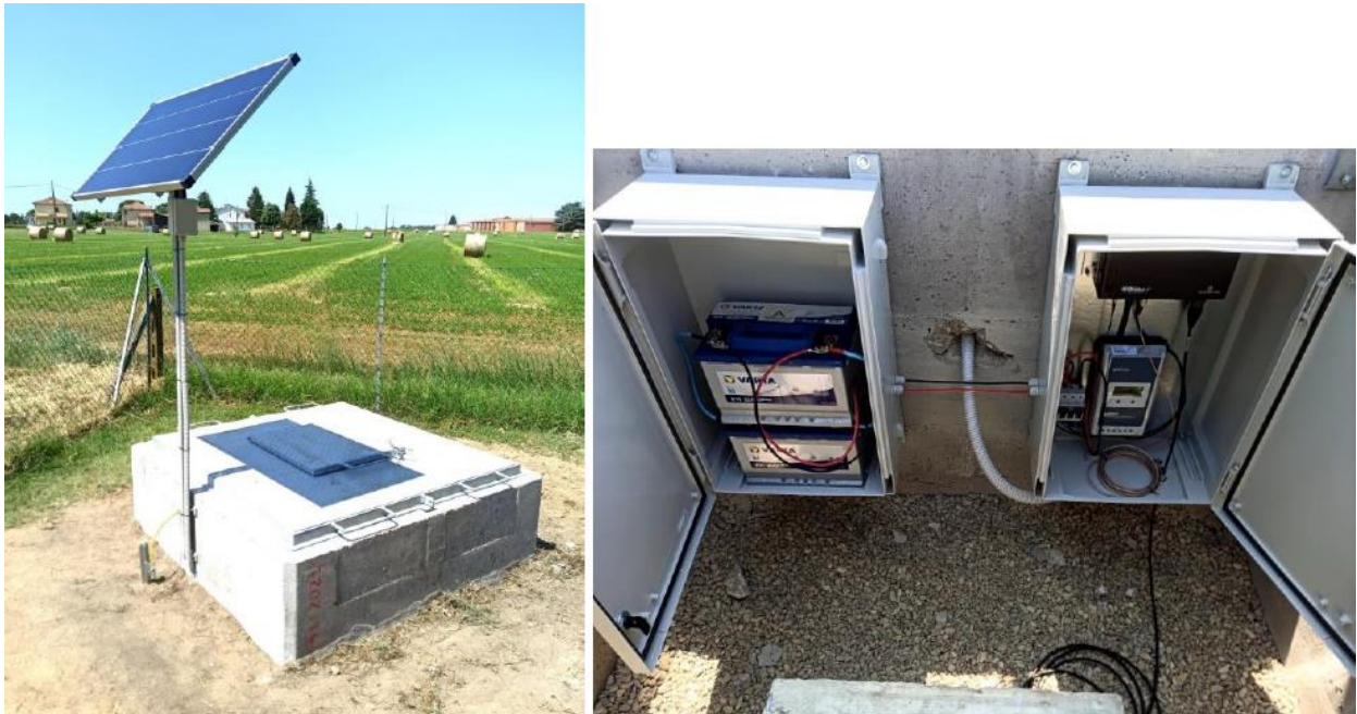
Fig. 15: Stazione sismica SMV04 – San Martino in Argine
