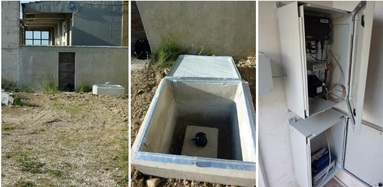
Fig. 13: Stazione sismica SMV04 – San Martino in Argine
