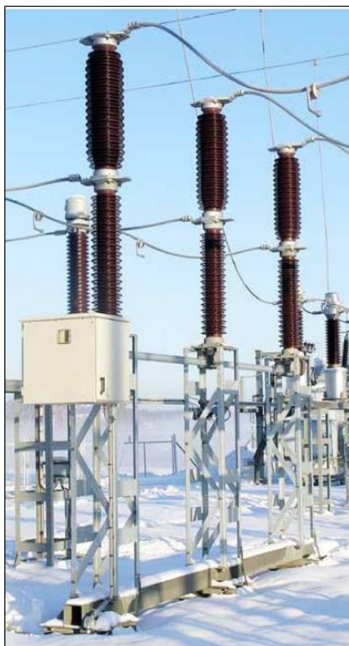
Figura 9.13. Particolare Interruttore con TA incorporato.
