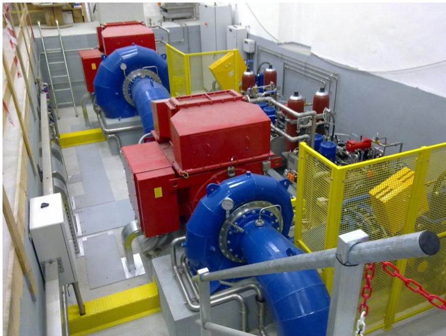
Foto di un'applicazione simile con n°2 turbine francis-alternatore ad asse orizzontale
