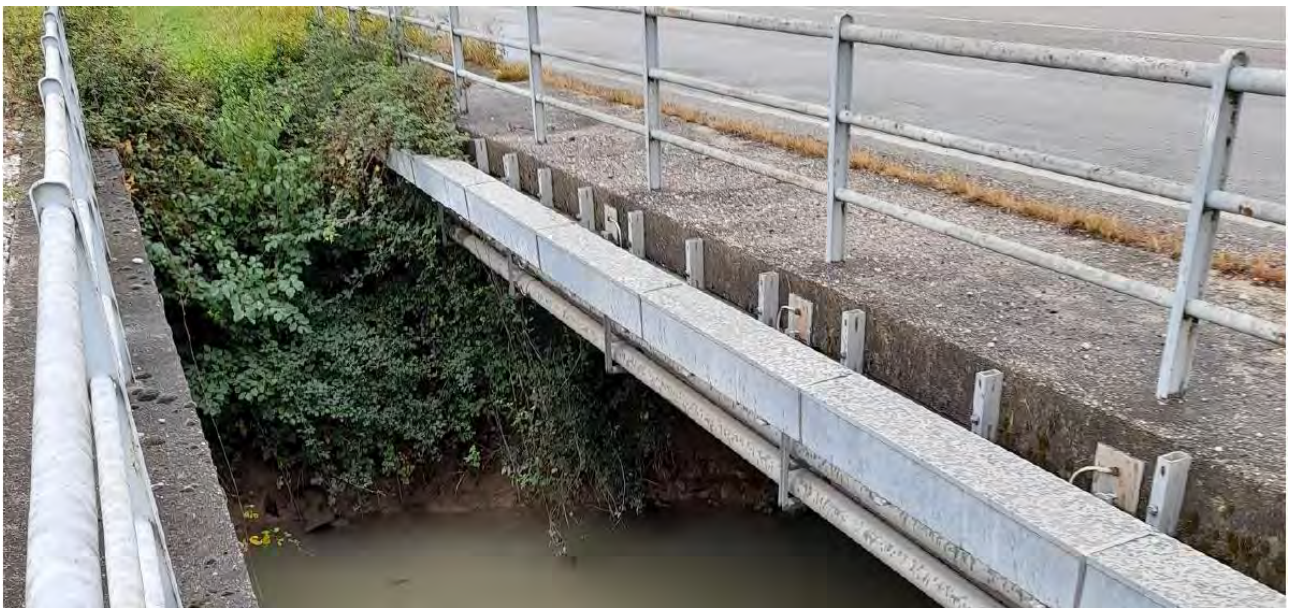
Immagine di riferimento di uno staffaggio elettrodotta su ponte
