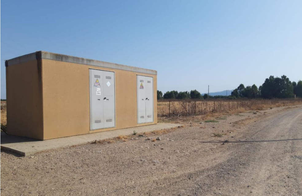
Figura 54: Cabine di trasformazione su stradello.
