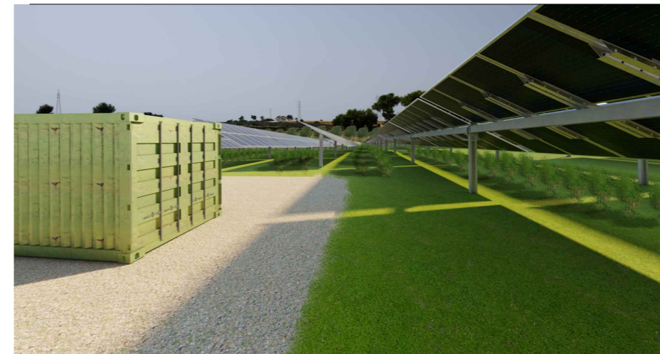
VISTA INTERNA DELL'AREA DI IMPIANTO - POST INSTALLAZIONE
