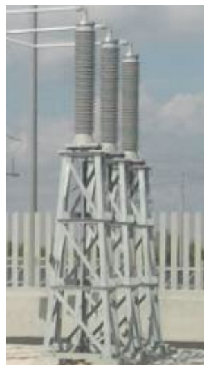
Figura 6: particolare terminale cavo AT
