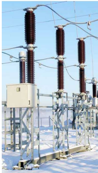
Figura 9: Interruttore AT 170 kV
