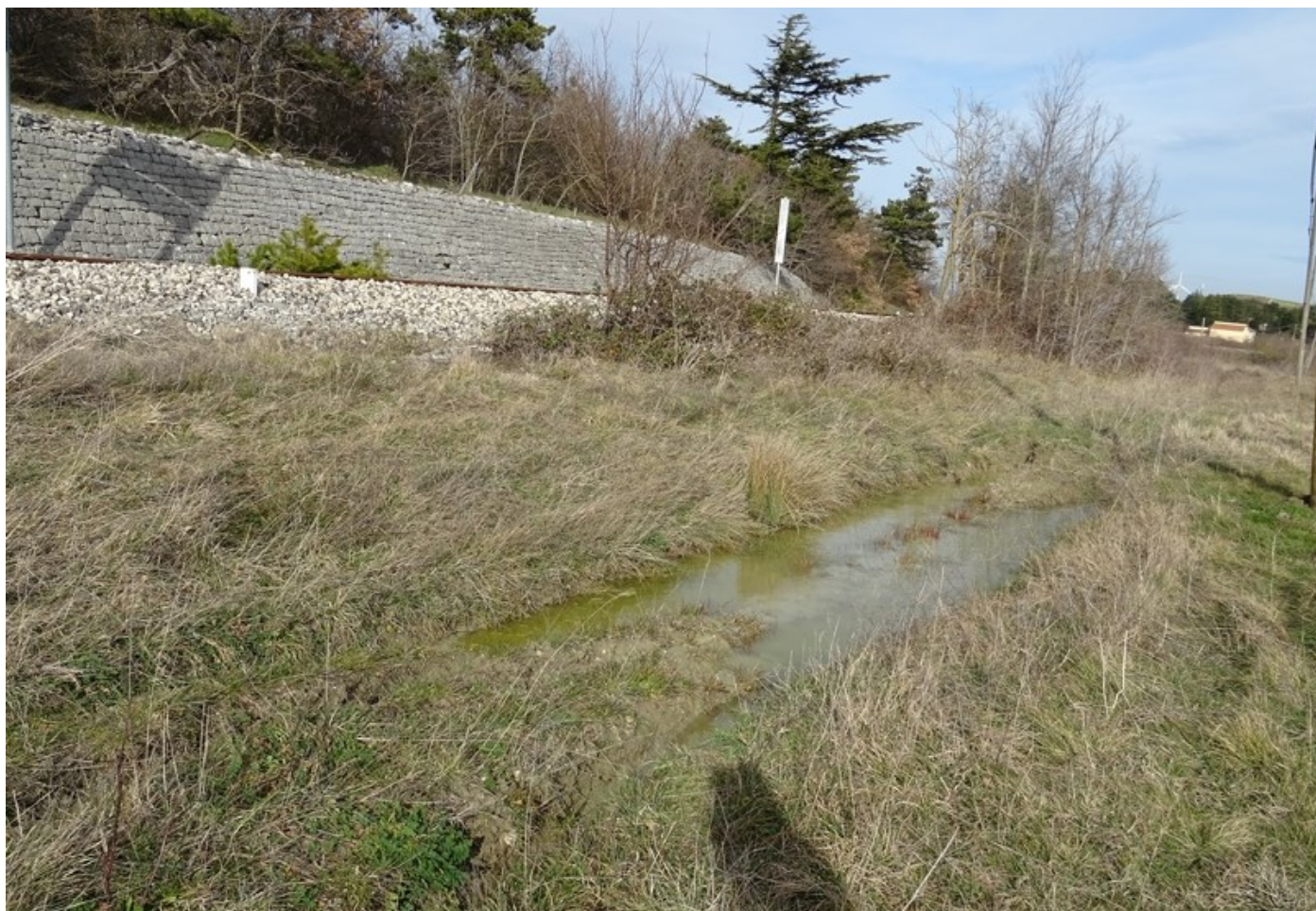
Foto 066 – Importanti ristagni idrici a monte della nicchia della frana Fr_04
