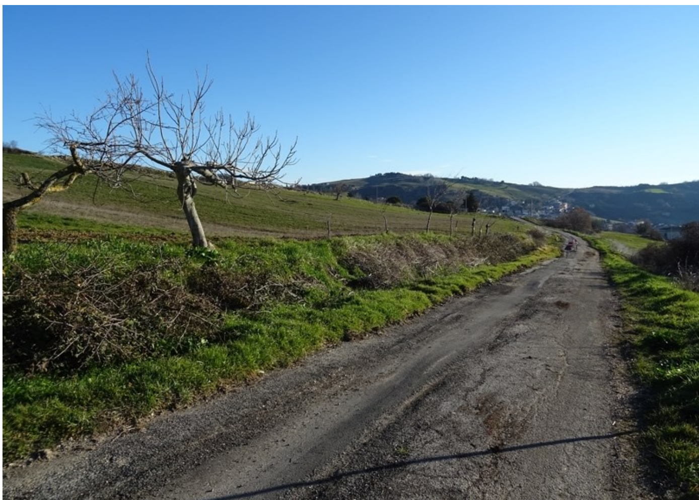
Foto 216 – Vista del dissesto stradale causato dalla frana posta a est del fabbricato “Casa de Luca”
