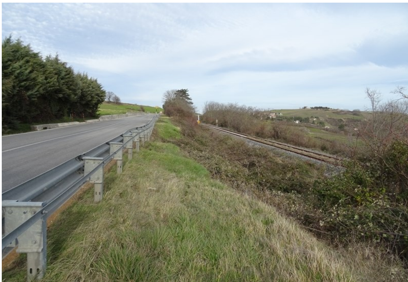
Foto 116 – Assestamento del corpo stradale a monte della Fr_08. Probabile prolungamento verso monte del corpo di frana
