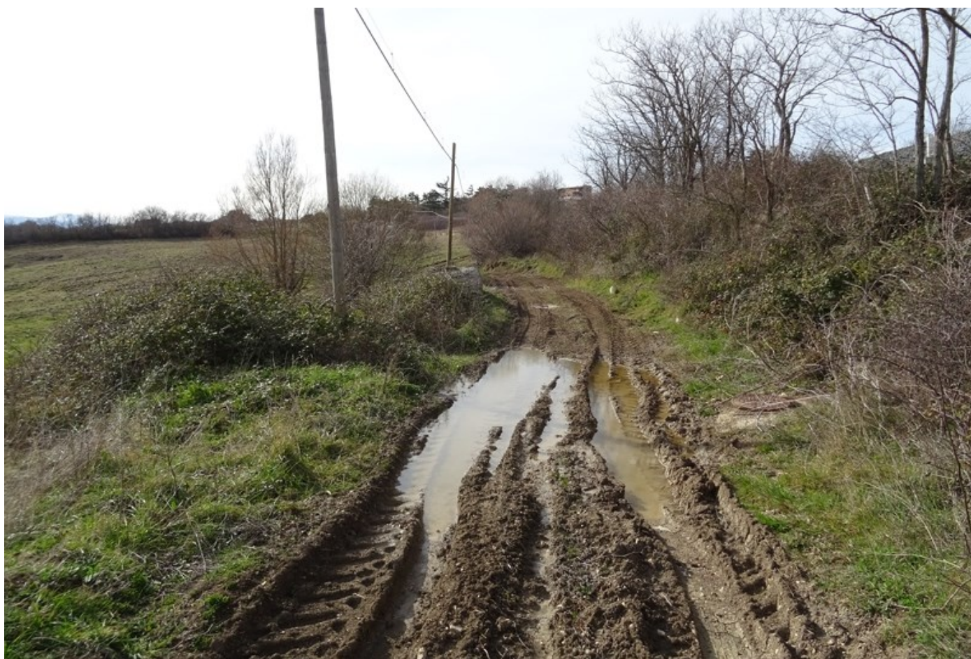
Foto 037 – Ristagni idrici in corrispondenza delle frane Fr_2d
