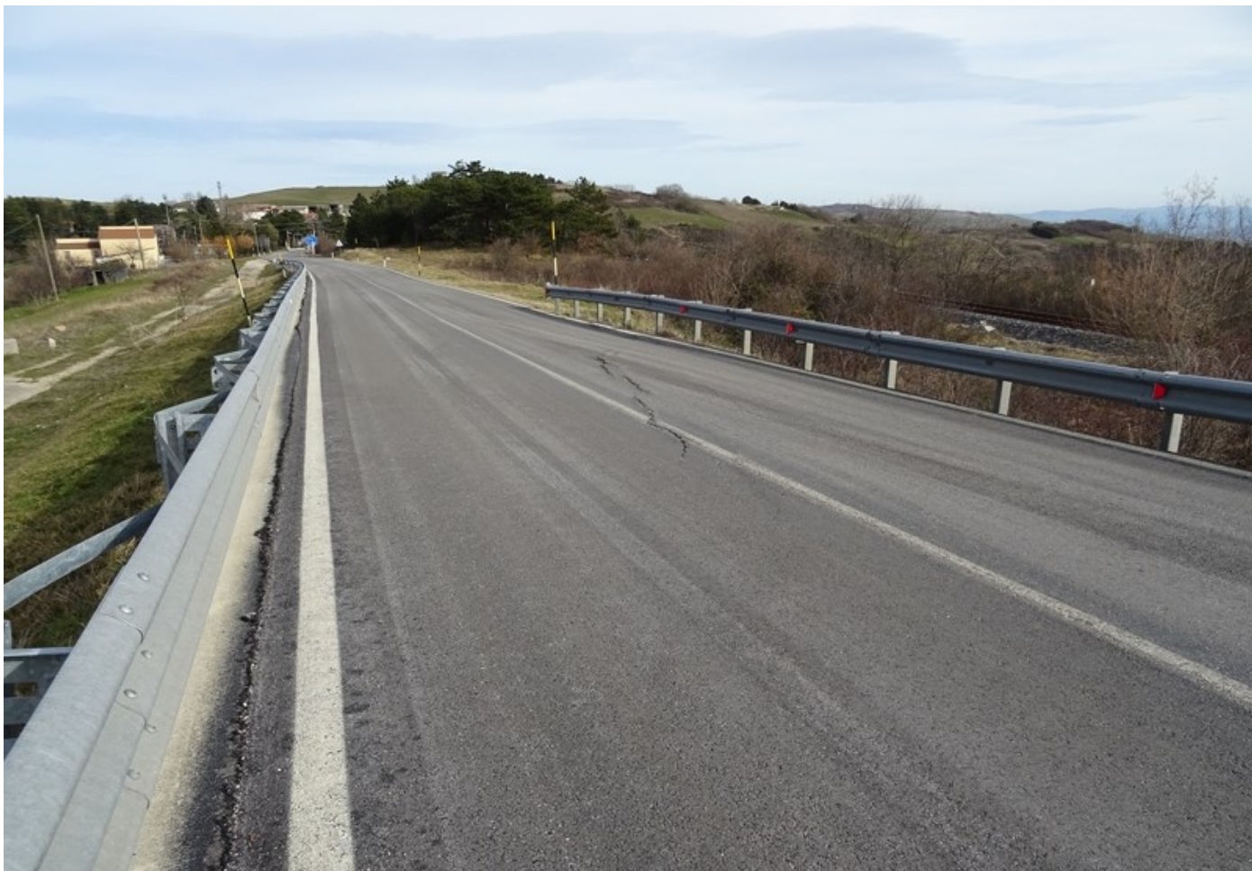
Foto 040 – Dissesto stradale a monte delle nicchie delle frane Fr_2c-d
