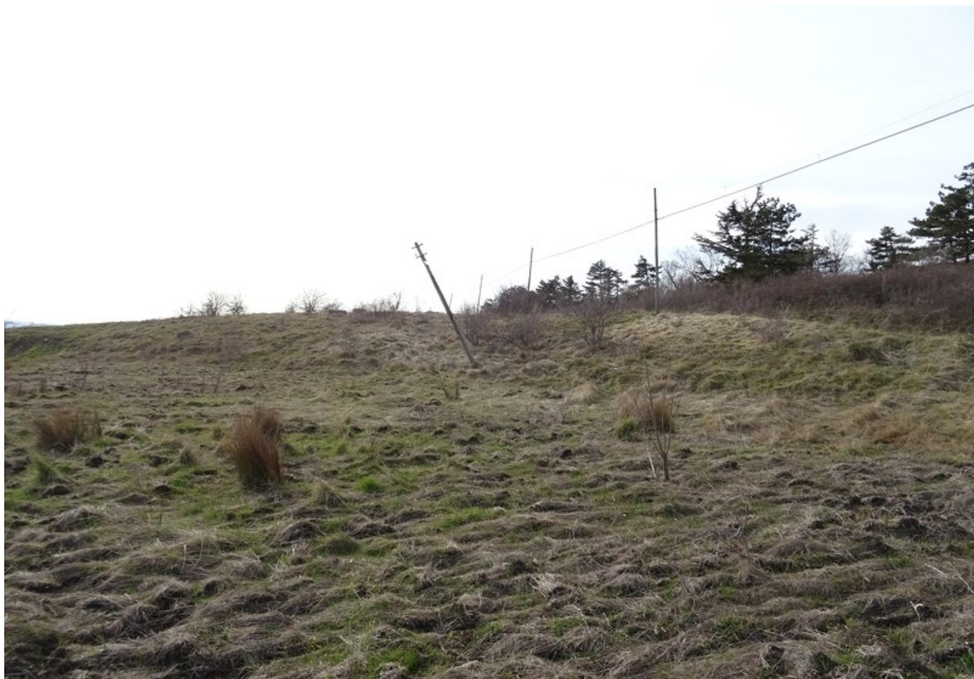
Foto 048 – Scarpata di scivolamento lungo il fianco occidentale della Fr_3b, dove è prevista la pila del viadotto della sez. n.39
