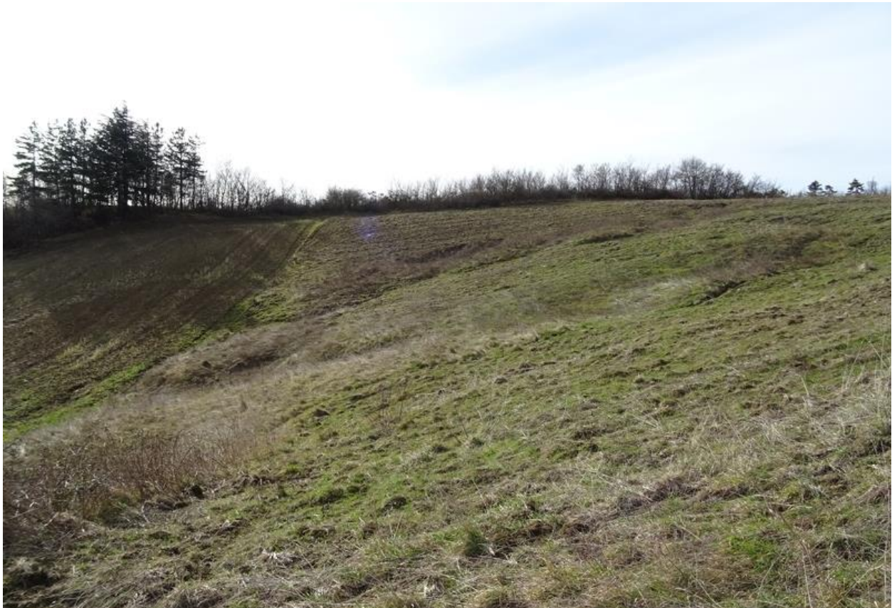
Figura 5 - Esempio di frane superficiali in corrispondenza del settore NE del tracciato in progetto
