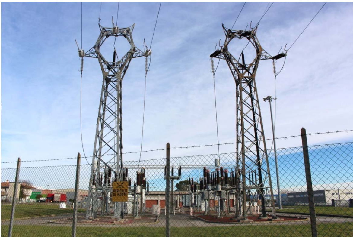
Foto 28 Centrale elettrica (Cabina Primaria) nella zona industriale di Fagagna (UD)
