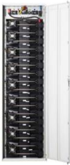
Fig.28: Esempio rack batterie
