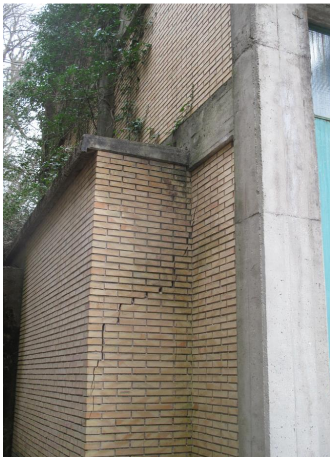
Figura 13: Lesione nel muro dell'edificio della camera a valvole dell'impianto Polverina
