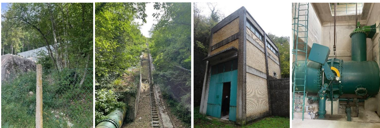
Figura 8: Da sinistra: vasca di espansione del pozzo piezometrico del Fiastrone; condotta forzata dal serbatoio del Fiastrone; cabina di manovra e camera interna delle valvole
