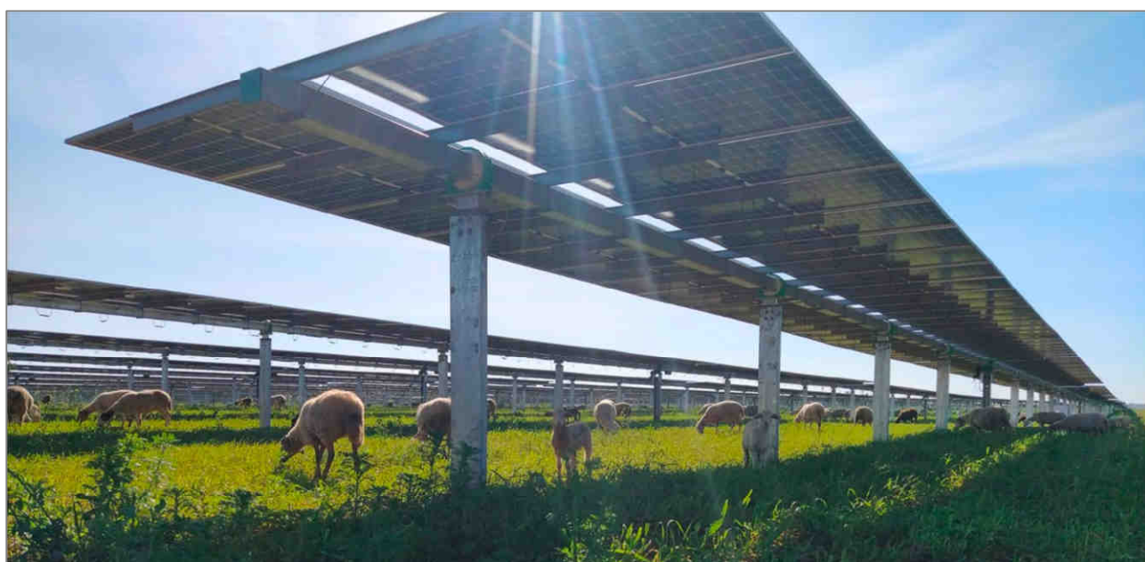
Strutture di sostegno e moduli – fotografia
