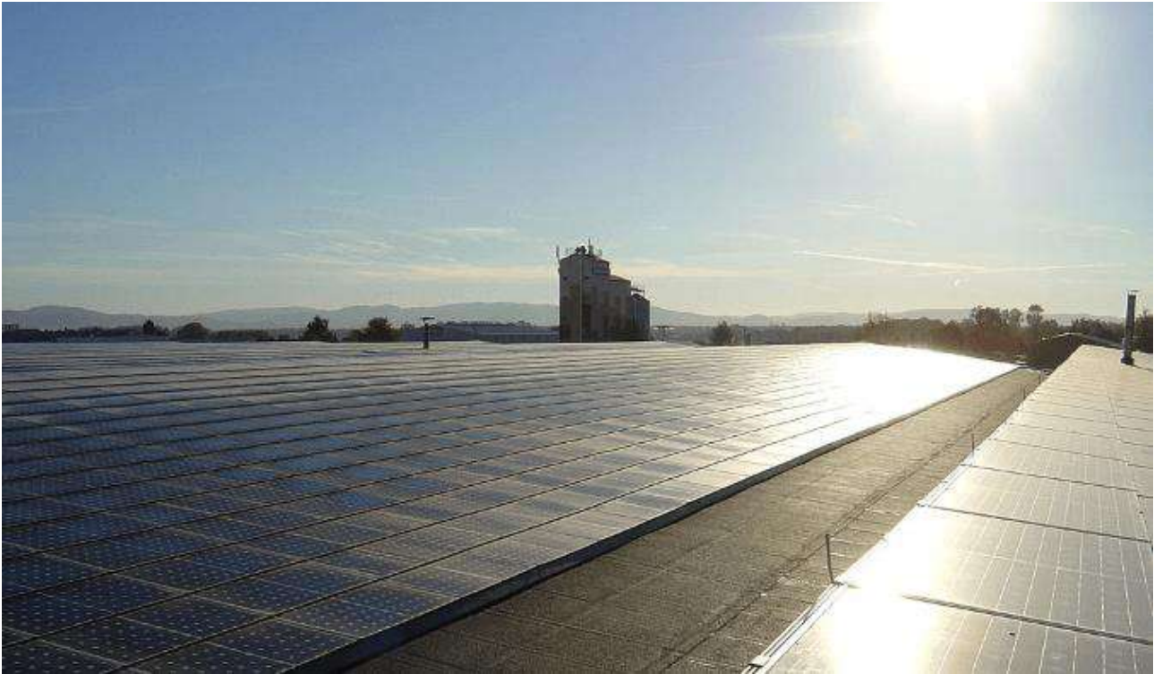
Figura 5 – Esempi tipici di abbagliamento causato da ampie superficie riflettenti (Fonte immagine sito: https://www.pagerpower.com/news/glint-glare-definition/ . Autore Micha Jost)
