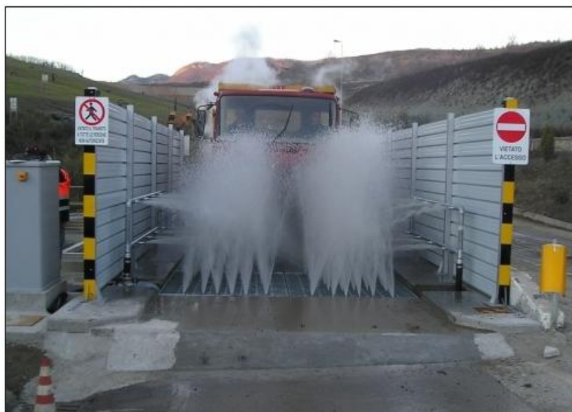
Figura 22 – Impianto lavaggio ruote
