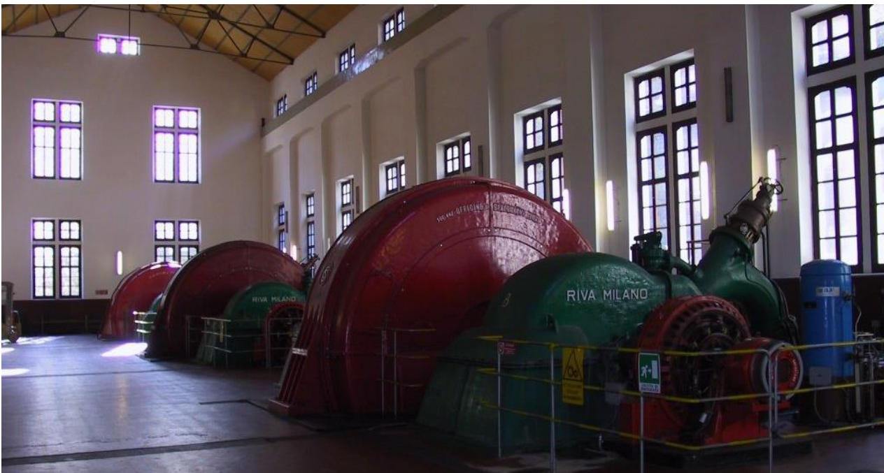
Fig. 3.16: Esempio di installazione con 2 Pelton accoppiate a unico generatore centrale installate in un altro impianto della CVA S.p.A.
