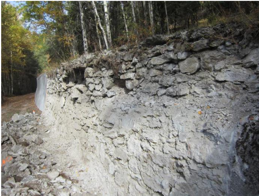
Fig. 2.1: Esempio di deterioramento del sistema di derivazione
