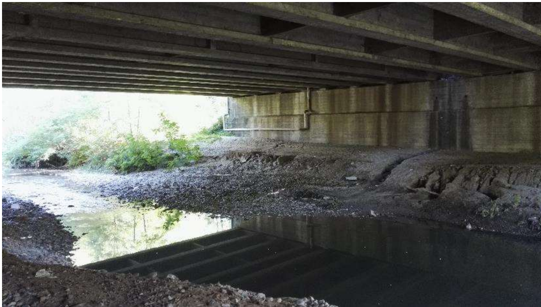
Figura 5-33 – Fenomeni erosivi al di sotto dell'impalcato sul Savena Vivo
