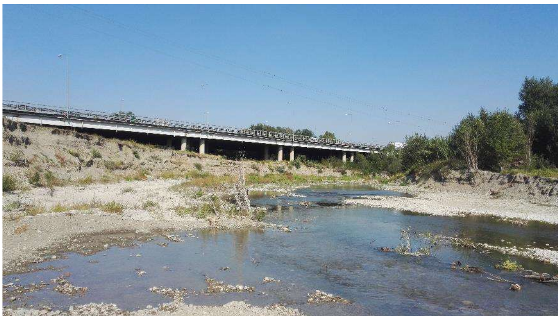
Figura 5-8. Erosione della golenale sinistra a monte del ponte
