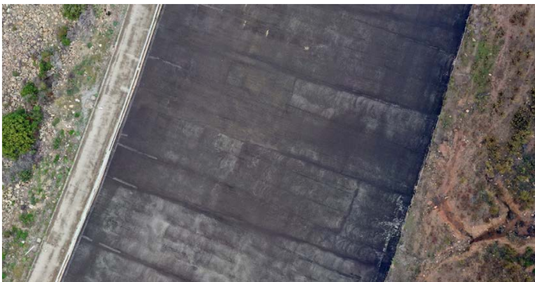
Figura 7.2.5: Diga di Medau, Stato fessurativo, Dettagli
