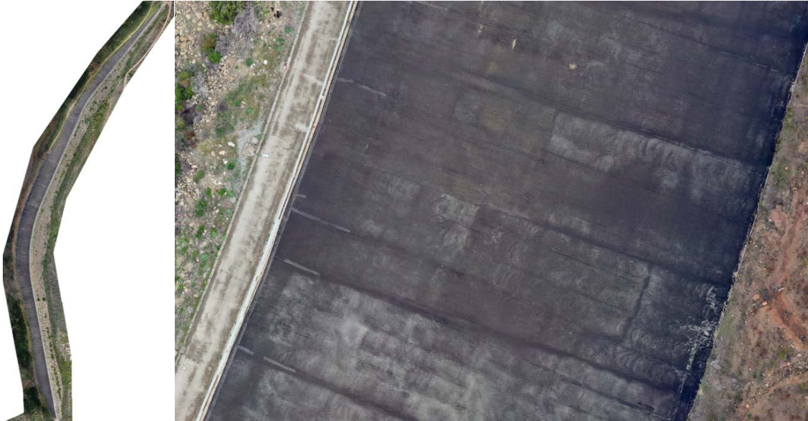
Figura 4.1.2: Diga di Carru Segau, Stato fessurativo
