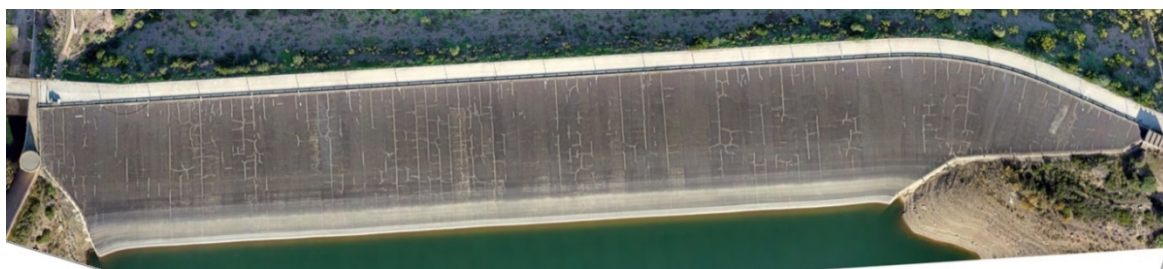
Figura 3.1.1: Diga di Medau, stato fessurativo
