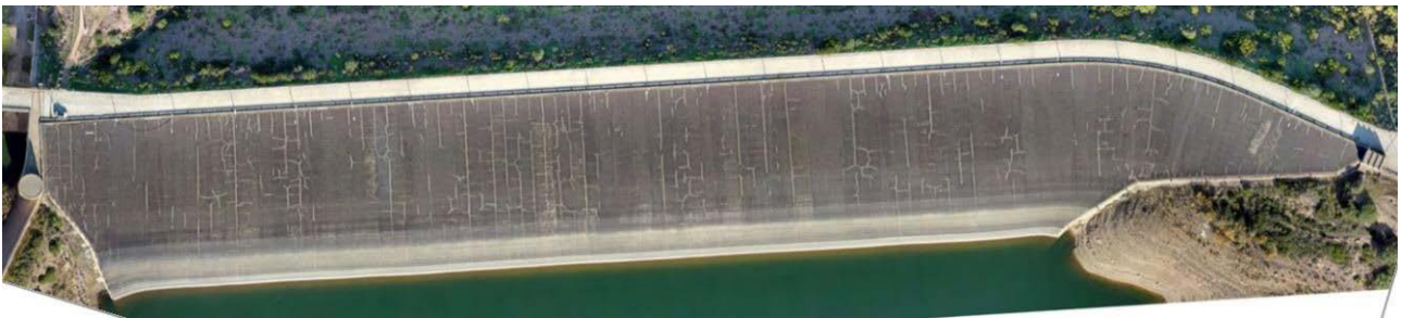
Figura 4.1.1: Diga di Medau, stato fessurativo
